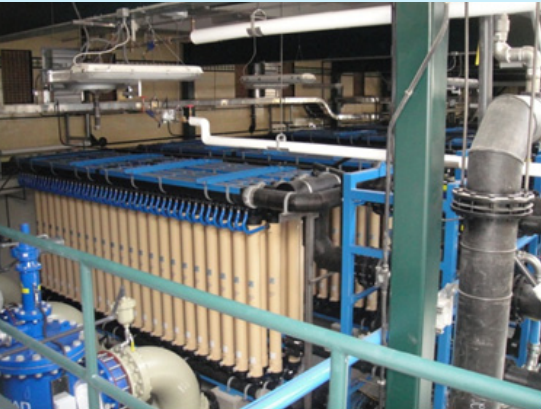
Módulos de membranas en la galería de filtros 1
